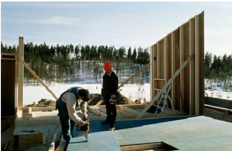
A felállított kereteket ideiglenes kitémasztásokkal rögzítik. A hosszabb falakat szakaszolva készítik el, a csatlakozásnál az egyik oldalon túlnyúló lemezt utólag csavarozzák össze a másik oszloppal.
